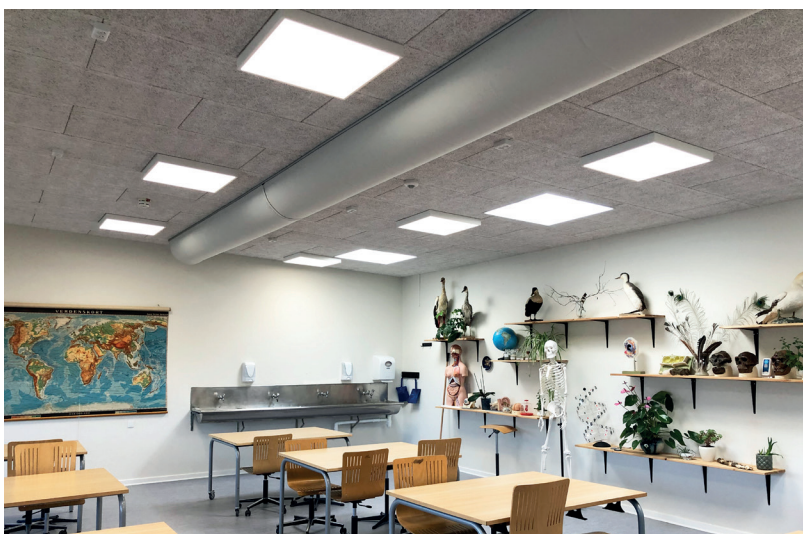
I faglokalet natur/teknik sikrer det nye ventilationssystem en konstant udskiftning af luften
