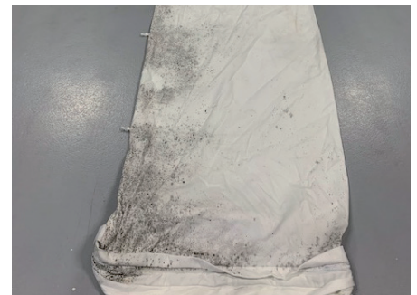
Tekstilkanal monteret i meget fugtigt miljø uden vedligehold.
